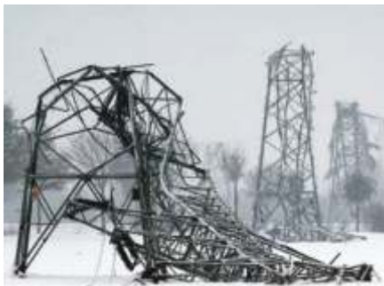
Abgeknickte Strommasten im Münsterland
