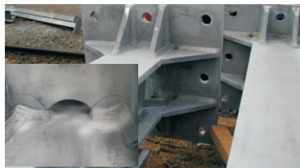
Verdeckte Risse nach MT-Prüfung im Bereich des steifen Fußpunktes einer Stütze
